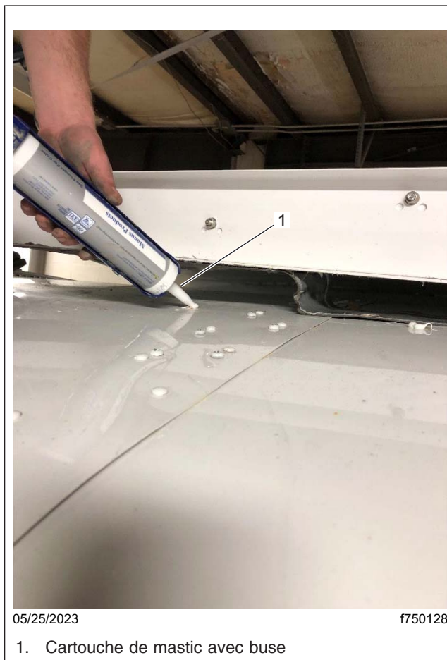
Fig. 6, A/C sur le toit scellé avec du mastic
