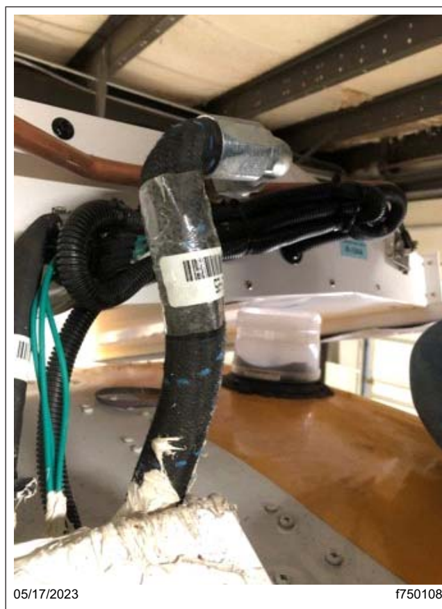
Fig. 7, Plomberie A/C sur le toit
